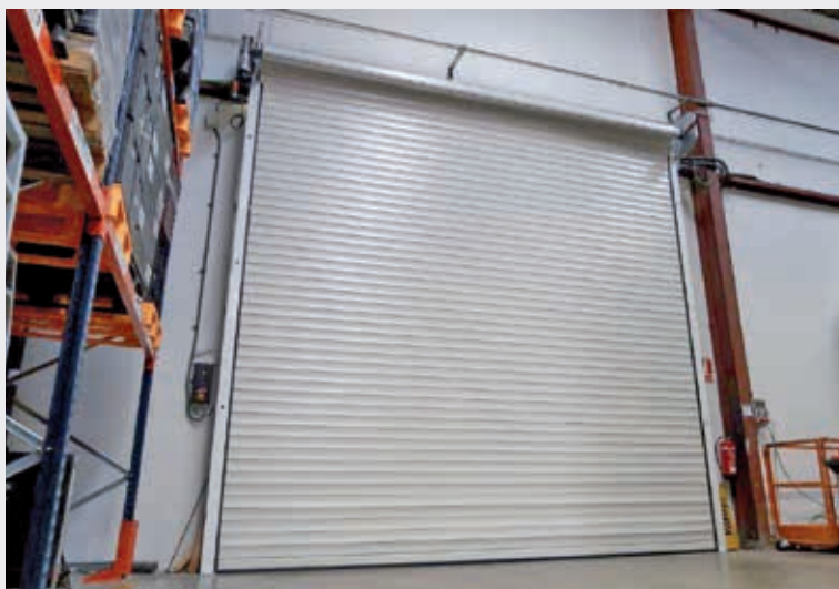
Puerta Mirtherm IST ® en interior de almacén.
